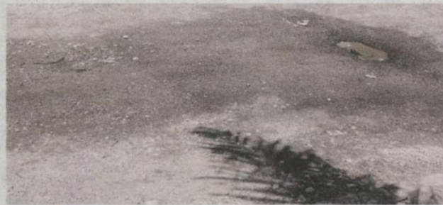
Permukaan jalan di persimpangan Taman Kem yang berlubang dan tidak rata membahayakan keselamatan pengguna jalan raya.
